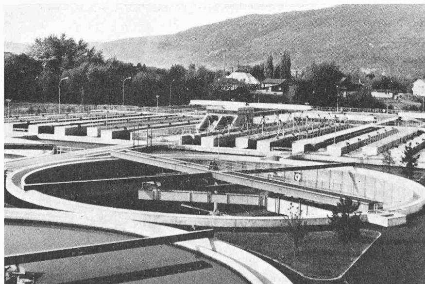
Bild 1. Kläranlage «Müra», Biel
