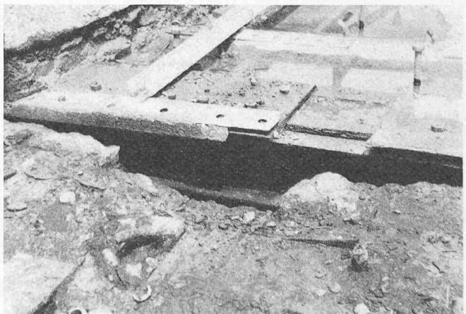
Bild 3. Stark verrostete Konstruktion eines Fahrbahnüberganges
