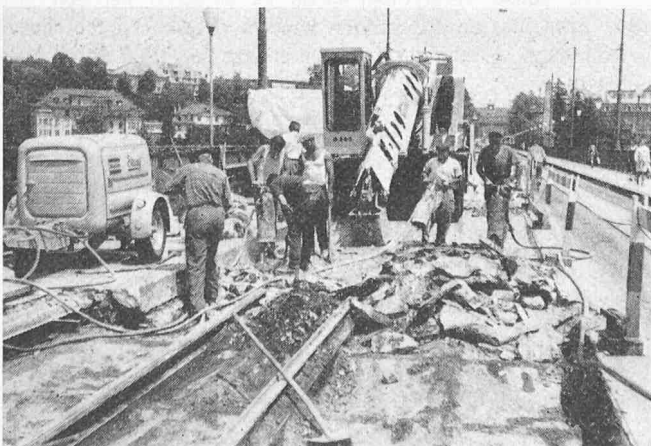
Bild 2. Abbruch der alten Fahrbahn. Stark unterschiedliche Qualität des alten Betons. Zwischen den Schienen verkitteter Kies, daneben Brocken, die normale Festigkeit aufweisen
