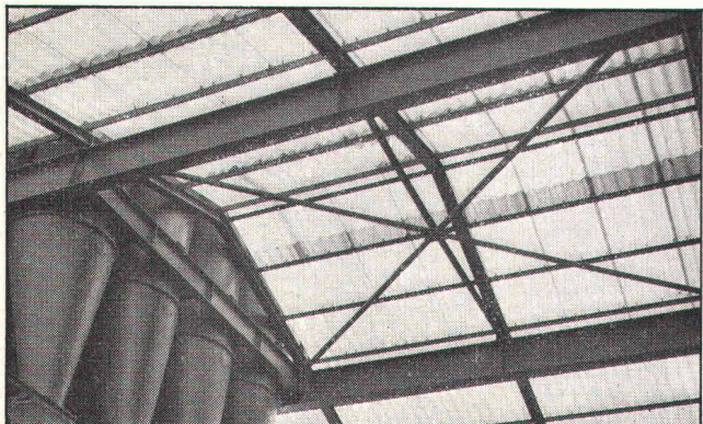
Neomat-Lichtdach auf einer Siloanlage
