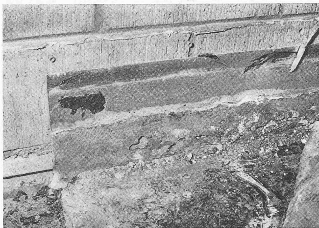
Sondierstelle, Zementüberzug und Zementschrittplatten entfernt; starke Korrosion bis zur Perforation beim vertikalen Teil des Winkelbleches
