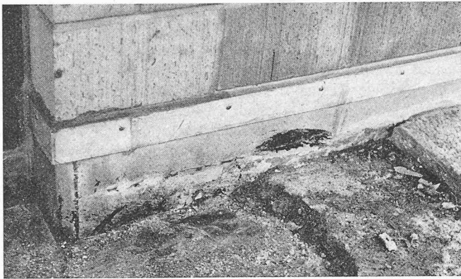
Winkelblechanschluss an das Gebäude, Zementschrittplatten und Zementüberzug teilweise entfernt; Zementüberzug in direktem Kontakt mit dem Winkelblech, dieses ist auf der Vorderseite nicht geschützt
