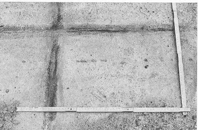
Dachhautoberseite, Schutzschicht Sand und Kies entfernt. Geradlinig verlaufende Wülste und Risse in der Dachhaut über den Fugen der Wärmedämmplatten
