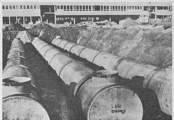
Behälter für 2000 m 3 Reinwasser
