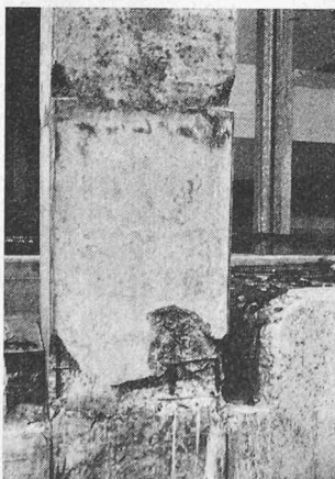
Bild 14 (nach dem 15. Sept.). Stützenfuss der Möbelfabrik Fantoni in Rivoli di Osoppo. Mit der Reparatur des durchrissenen Stützenfusses wurde eine Wiederherstellung der ursprünglichen Tragfähigkeit angestrebt. Die erneute Bebenbelastung bewirkte gleichartige Schäden wie beim ersten Erdstoss, die reparierten Einspannstellen der Stützen wurden neu durchrissen, und der Beton platzte in den höchstbeanspruchten Bereichen ab
