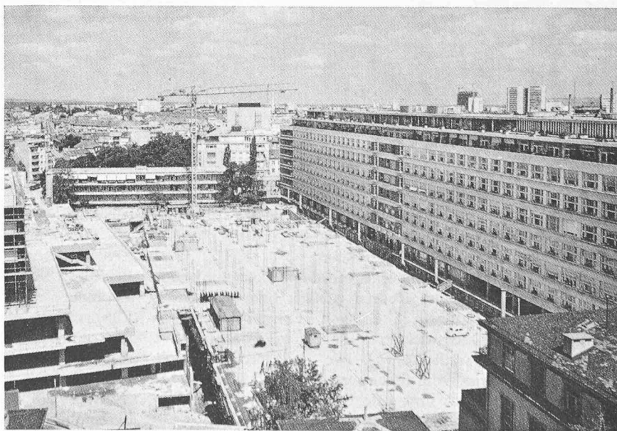
Bild 1. Vogelschau der Baustelle. Die grossflächige, fünfstöckige Tiefgarage liegt unmittelbar neben dem bestehenden Spitalgebäude. Die über die oberste Decke herausragenden vertikalen Spannstrangen dienen zum Absenken der darunterliegenden Decken
