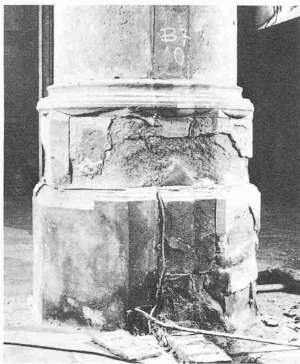
Bild 3a. Pfeiler B7. Die «elektro-physikalische Mauerrockenlegung» hat die Zerstörung des Steingefüges nicht verhindern können (Aufnahme: Mai 1975)
