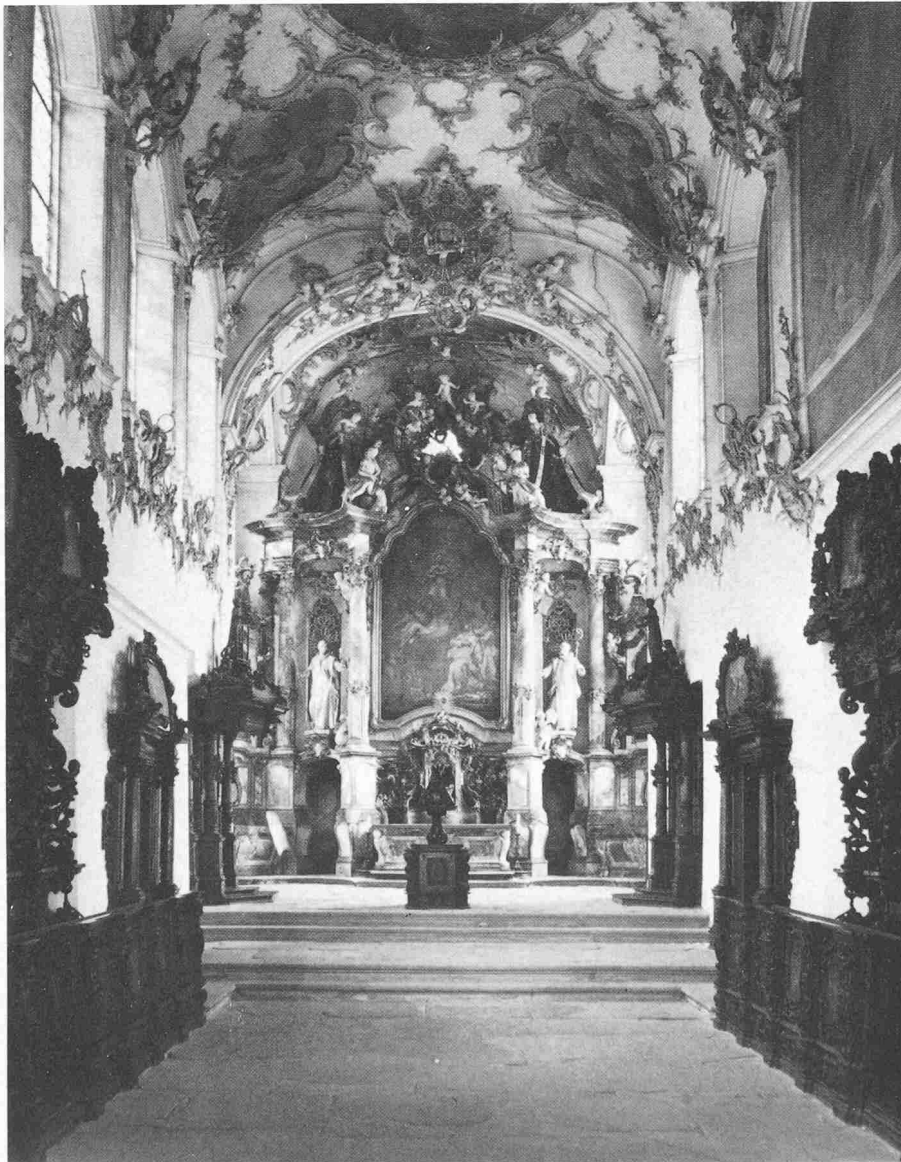
Bild 4. Chorbogen mit Schrägrissen
