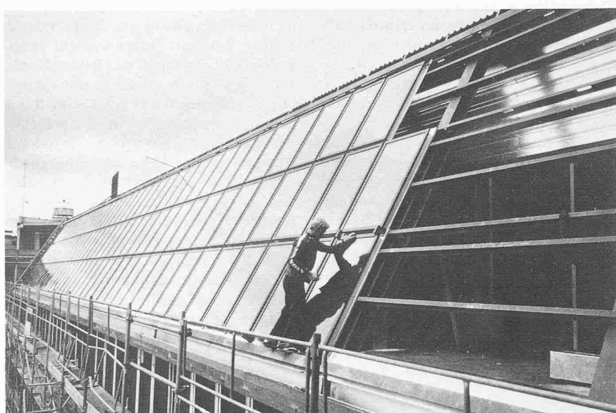
Das Sonnenkollektorenfeld für die Brauchwasserheizung auf dem westlichen Gebäudetrakt. Die Kollektoren bilden gleichzeitig die Dachhaut
