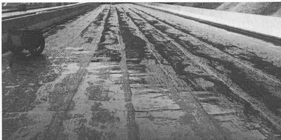
Bild 8. Überlappungen bei einer kunststoffmodifizierten Bitumenfolie bilden Wasserstau, der in den Hohlräumen des Walzasphaltes bleibt
