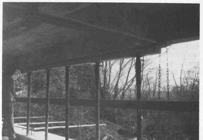
Bild 7. Anpressen der Bleche an den Konstruktionsbeton. Mit den Deckenspriessen und dem Kantholz wird ein gleichmässiger Anpressdruck erreicht. Die Spriessen stützen sich auf dem Gerüst ab, das mit Ketten an der Brücke befestigt ist
