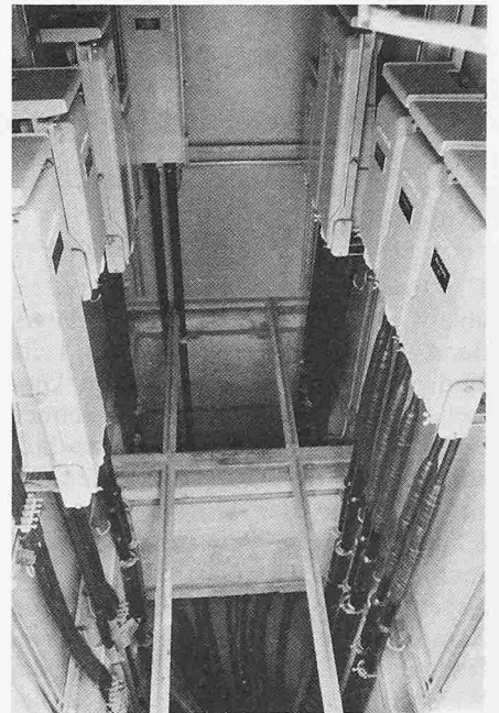
Bild 9. Kabelstützpunkt für Umschaltmöglichkeit im Störfall
