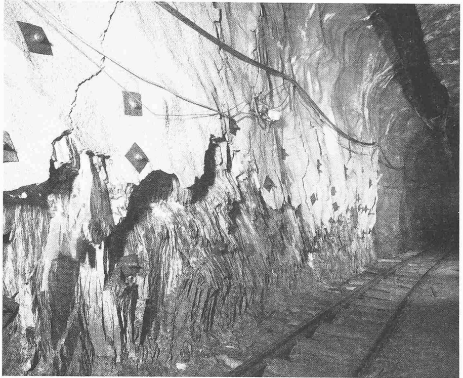
TM 1570: Zustand am 23. Februar 1978, drei Jahre nach dem Ausbruch. Sichtbar sind der beim Vortrieb benötigte Sicherheitsgunit, die Anker, die Ausknickungen und Ablätterungen der feinschichtigen Paragneise. Überlagerung: etwa 500 m
