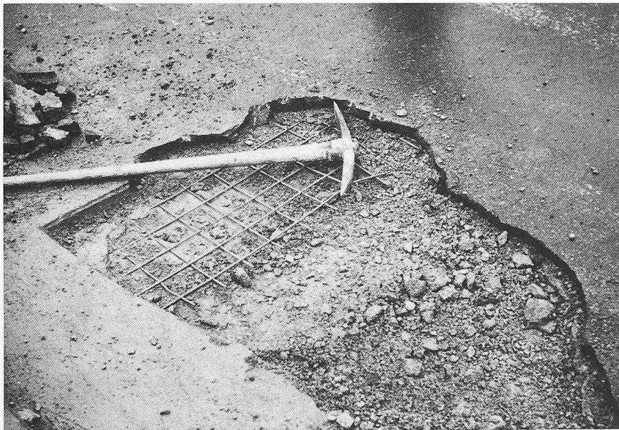
Bild 19. B-058 Reussbrücke Gebenstorf. 1976 mussten Schäden an der Stampfbetonplatte aus dem Jahre 1930 notdürftig geflickt werden. Dies löste umfangreiche Untersuchungen der Brücke und ihrer Fundationen aus...
