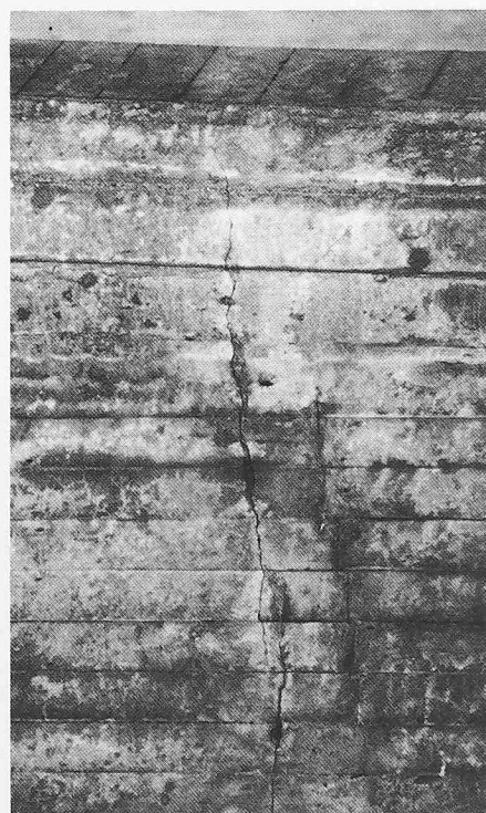
Bild 5. Risse in der Konsole einer Überführung über die N3 bei Rheinfelden. Ansicht von unten
