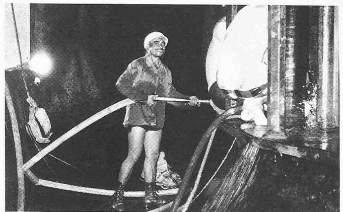
Bild 25. Arbeiten im Innern einer Francisturbine mit unzulässigen mobilen Beleuchtungseinrichtungen von 220 Volt; Einrichtungen mit Kleinspannung fehlen hier
