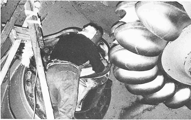
Bild 24. Arbeiten im Innern einer Pelton-turbine mit unzulässigen, improvisierten Beleuchtungseinrichtungen von 220 Volt; Einrichtungen für Kleinspannung fehlen hier
