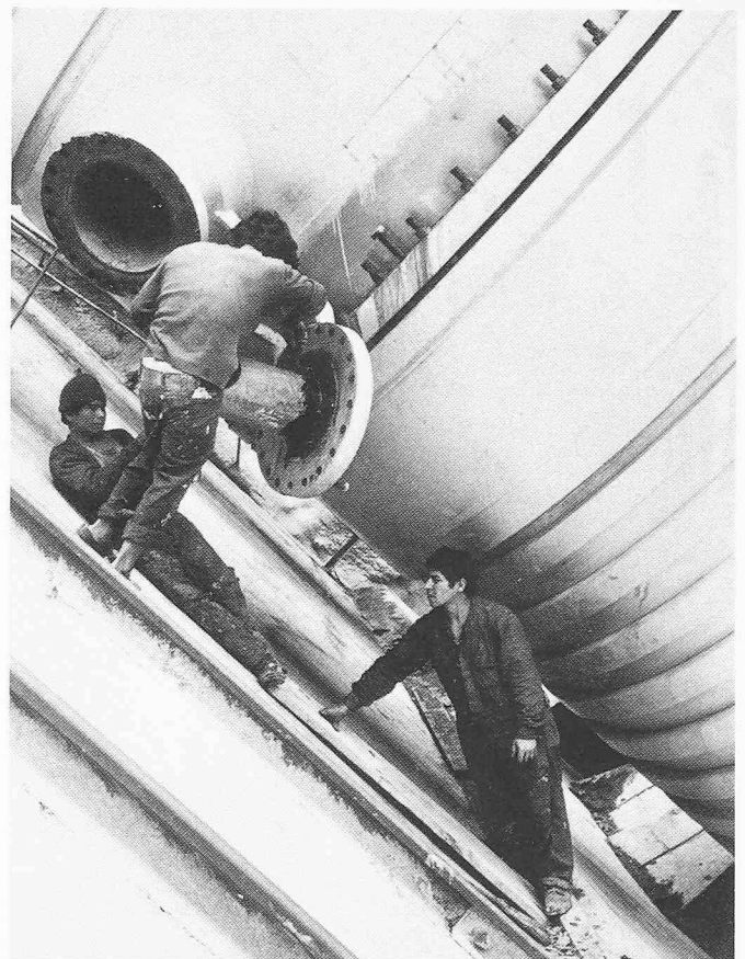
Bild 10. Das Ein- und Aussteigen durch dieses ohnehin zu enge Mannloch ist hier besonders schwierig. Ein gefahrloses Arbeiten an der Druckleitungsexpansion (z. B. Nachziehen der Schrauben über den ganzen Umfang oder Auswechseln der Dichtungsschnüre) ist unmöglich
