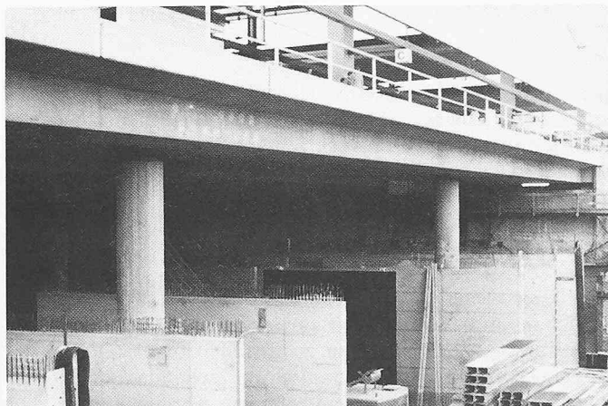
Bild 5. Bereits fertig erstellte Brücken unter den bestehenden Bahngleisen zur Einführung der S-Bahnen, darüber die neue Bahnhofshalle
