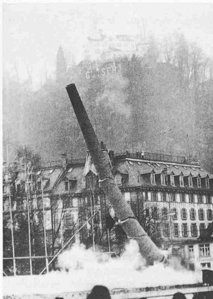
Bild 1. Beispiel für Knickstelle (Schlachthof Luzern)
