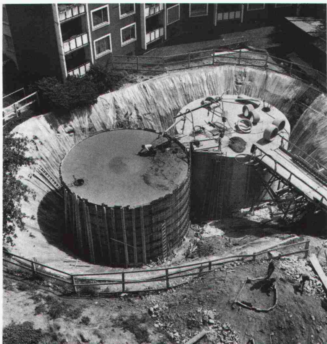
Überbauung Heiligfeld, Zürich: Diese beiden Heizöltanks aus Beton fassen zusammen 500 000 Liter Heizöl. Nach Fertigstellung sind sie unsichtbar im Erdreich.
