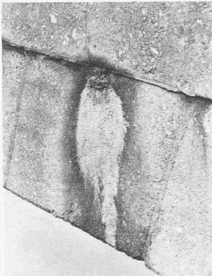
Bild 5. Wasseraustritt und vorgeschobene Stirnmauer, vor der Sanierung
