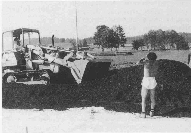
Bild 3. Verteilen und Planieren der zementstabilisierten Kehrichtschlacke auf der Baustelle. Die Verarbeitung kann auch mit einem Fertiger erfolgen
