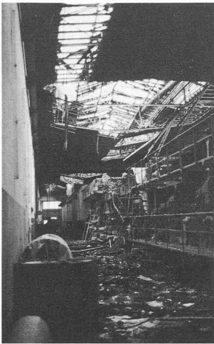
Bild 1. 15. Dezember 1982. Blick in die durch einen Grossbrand zerstörte Maschinenhalle. Herabstürzende Deckenteile haben die Kartonmaschine stark beschädigt. Durch Hitze und Feuer sind Tragkonstruktion und Dach vollständig zerstört worden
