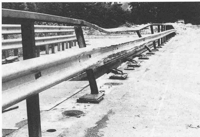
Bild 10. Schaden an der Leitschranke mit Planke Profil A und Handlauf, nach einem Lastwagenanprall (5,6 t, 71 km/h, 15°)
