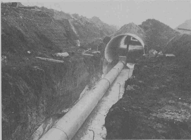
Einbetonierte PVC-Leitung in Armco-Rohr
