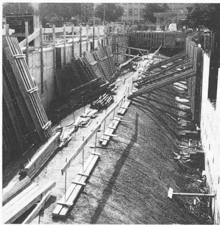
Bild 15. Eulachquerschnitt in der Bauphase. Die grossen Aussparungen in den Wänden dienen als Auflager für die Abfangträger
