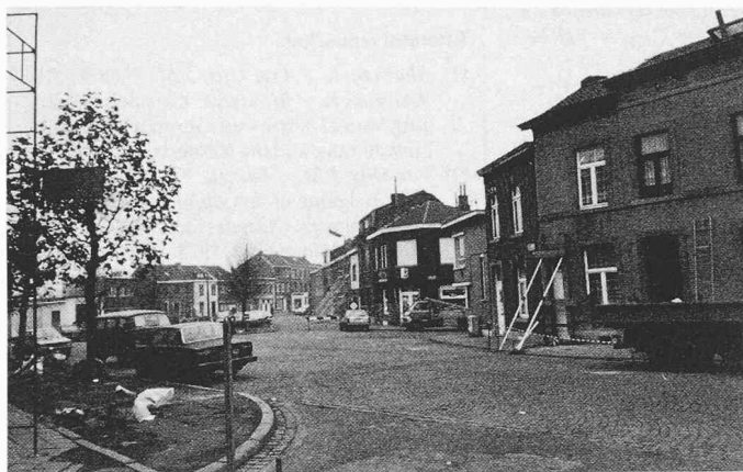
Bild 6. Strassenzug in Saint-Nicolas mit den typischen zweistöckigen Backsteinbauten. Einzelne Fassaden mussten gestützt werden
