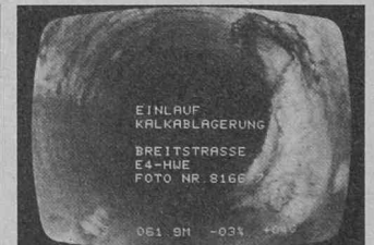
Auf dem Monitor werden Messwerte wie Distanz, Längsgefälle und Querverneigung im Fernsehbild festgehalten
