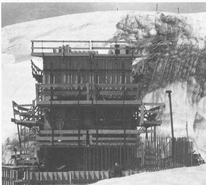
Bild 12. Rohbau Juni 1982: Schalen und Armieren am 2. Untergeschoss und am aufstrebenden Liftturm. Im Hintergrund die Schneewächte vom Chli Titlis
