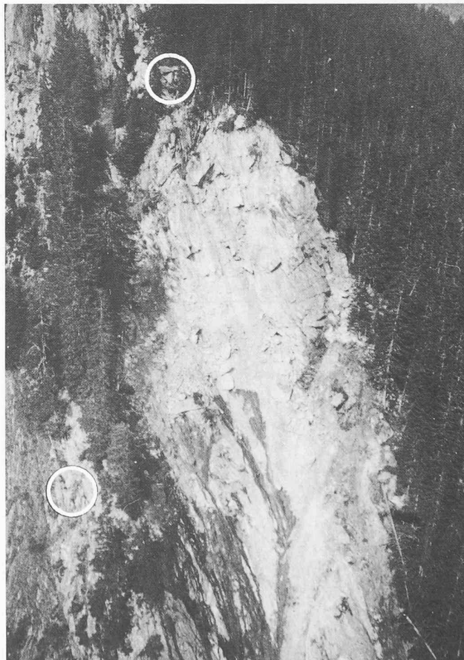
Bild 3. Der Felsturm ob Schwandi am 1. Oktober 1983 von SW nach dem Absturz (Kreise = Referenzpunkte zu Bild 2)
