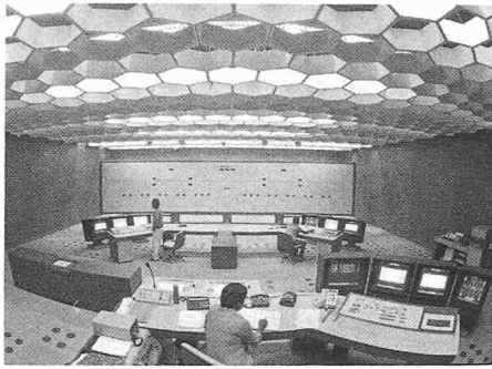
Bild 10. Kontrollraum mit SCADA-8-Steuerungsanlage
