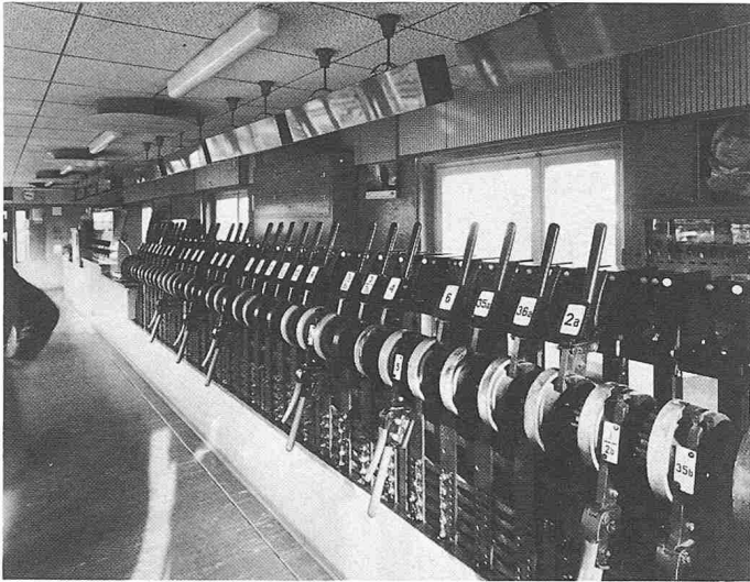
Bild 2. Blick ins bestehende Stellwerk aus dem Jahre 1898
