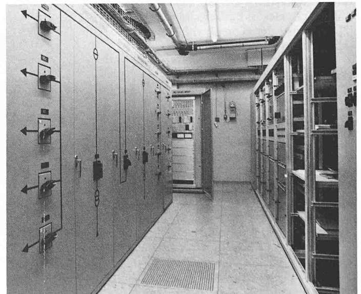
Bild 3. Niederspannungsverteilung mit Grobnetzverteiler, E-Technik-Schränken und Messtechnikschrank
