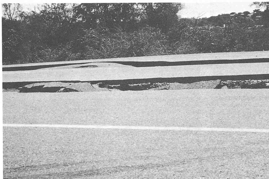
Bild 12. Risse im Strassenkörper im Anschluss an die Brücke über den Rio Balsas (vgl. Bild 11)
