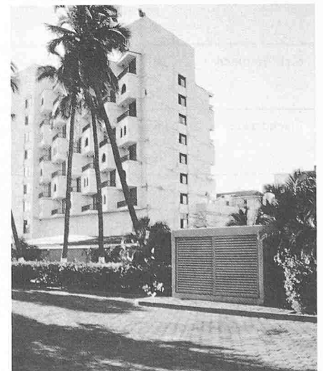
Bild 9. Schäden am «Aristos»-Hotel in Ixtapa. Analoge Schäden waren bereits beim Erdbeben 1979 aufgetreten (vgl. [3])
