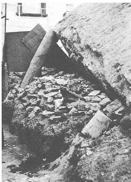
Bild 23. Beim Kippen des Gebäudes (Bild 22) wurden die Pfähle auf der einen Seite aus dem Boden herausgezogen
