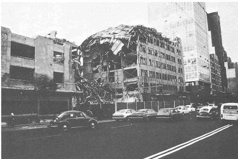
Bild 24. Obwohl die obersten Stockwerke total einstürzten, blieb die Tragstruktur der unteren Geschosse stehen
