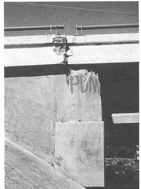
Bild 11. Schäden an einer Brücke über den Rio Balsas bei Lazero Cardenas: Aufprall des Brückenträgers auf das Widerlager
