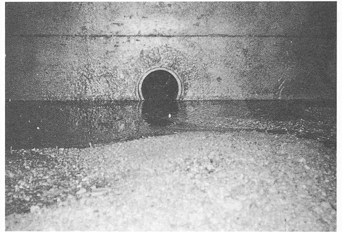
Bild 10. Kies-Sand-Ablagerungen vor einem Überfallrücken einer Toskammer (Blick in Fließrichtung). Die Spülwirkung des Trockenwetterdurchlasses ist nicht ausreichend
