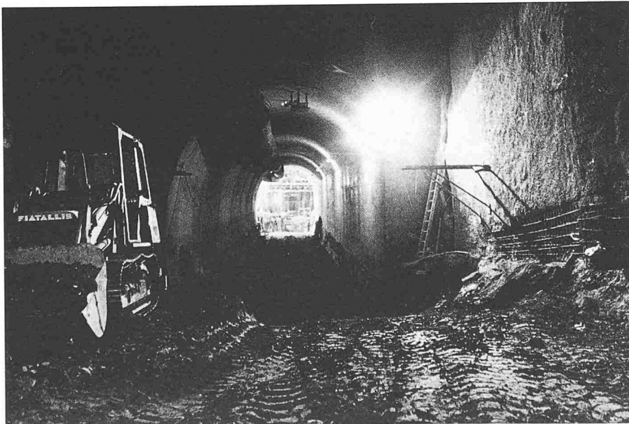
Bild 3. Unterfahrung Publicitasgebäude: Aushub im Schutz der auf Pfählen fundierten Bodenplatte; Blick Richtung Schacht Limmat, mit dem ausbetonierten Gefrierabschnitt der Axe 200
