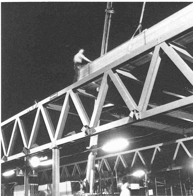
Bild 3. Für die Montagearbeit bei ausgeschalteter Fahrleitung standen nur kurze Nachtstunden zur Verfügung
