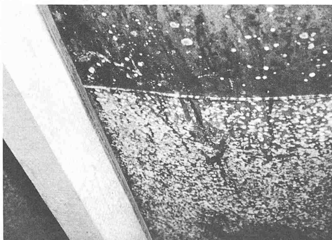
Bild 2. Pilzbildung am Unterdach
