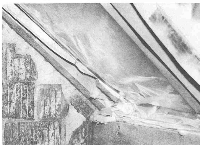
Bild 3. Nicht luftdichte Anschlüsse bei Sparren und Schwelle
