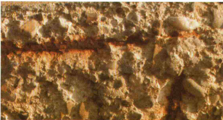
Betonabplatzungen infolge starker Armierungskorrosion.
