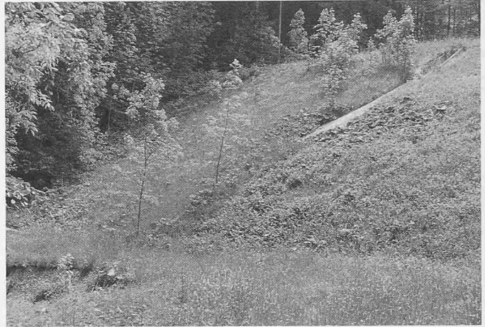
Bild 12. Luftseitige Ansicht des Dammes am Sülübach ZH mit den 1984 erlittenen Auswaschungen (Foto des Autors)
