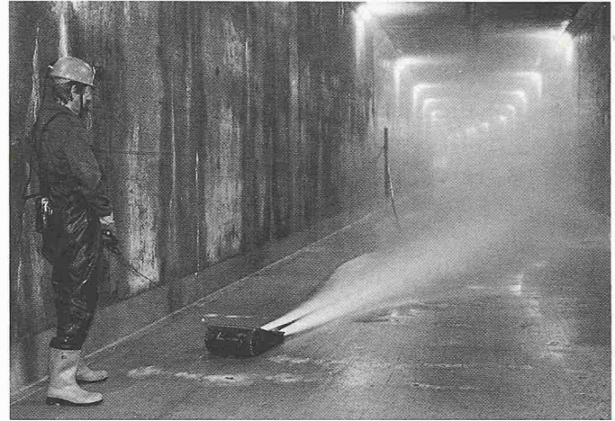
Bild 8. Schwingdüse zur Reinigung des Zulaufkanales
