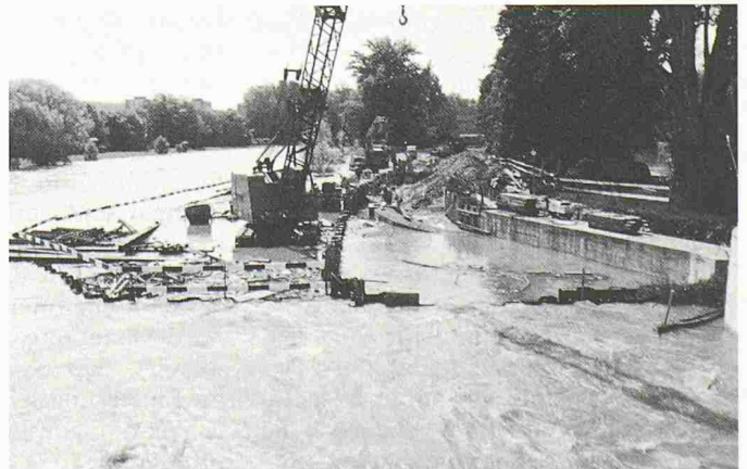
Bild 4. Überflutung vom Juni 1986. Blick vom Höneggerwehr limmataabwärts
