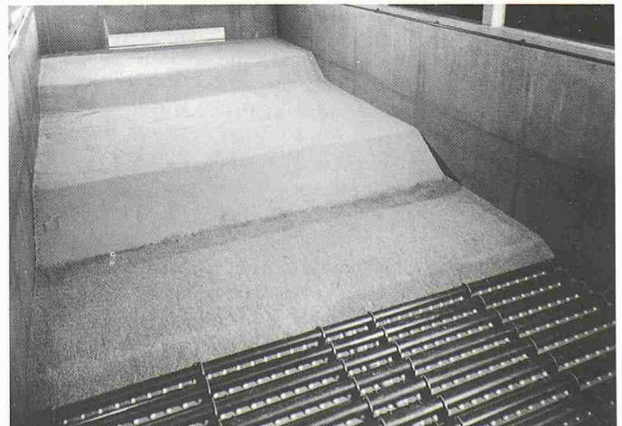
Bild 3. Blick in Drainagefilter 87
