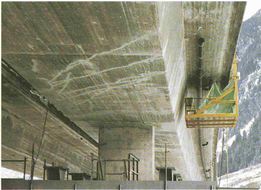
Bild 19. Entwässerungsleitung und ausinjizierte Risse im Überbau und Pfeilerkopf (A. von Glutz)
