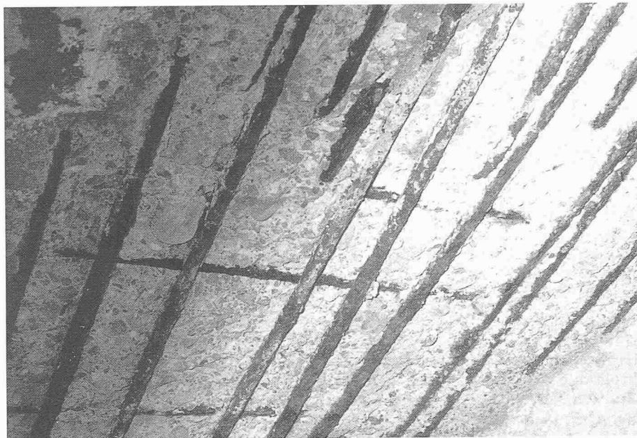
Bild 1. Korrodierte Bewehrungsstähle haben die Betonüberdeckung abgesprengt
