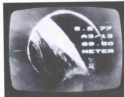
Wassereintruch bei Rohrmuffe
