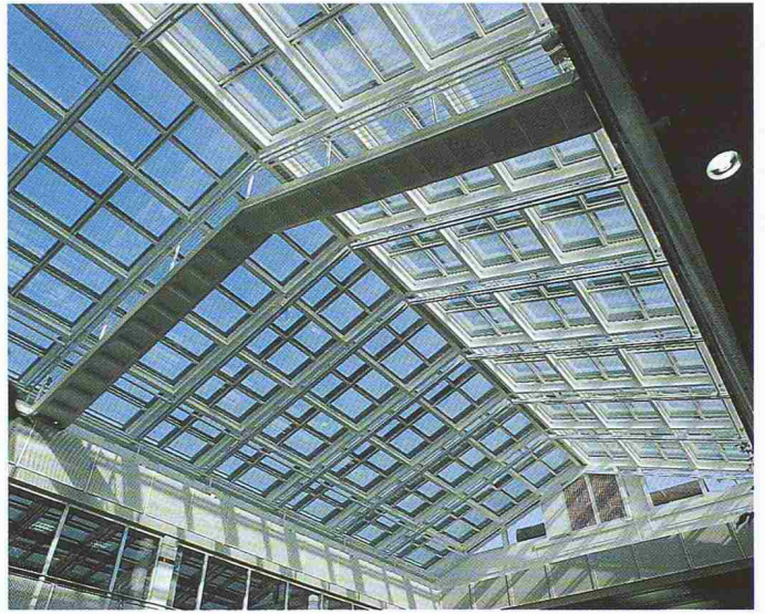
Die gesamte Glashaut kann zur Reinigung geöffnet werden. Durch Ausbildung ähnlich dem Kalt-Fassadensystem konnte die Schalldämmung noch wesentlich verbessert werden
