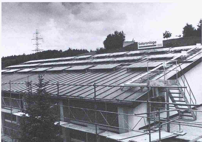
Bild 1. Die photovoltaische Anlage des EKZ in Aathal mit den drei Feldern unterschiedlicher Technologie, Leistung und Hersteller. Die zu Arrays zusammengefassten Zellen sind mit speziell konzipierten Distanzhaltern auf dem Dach befestigt
