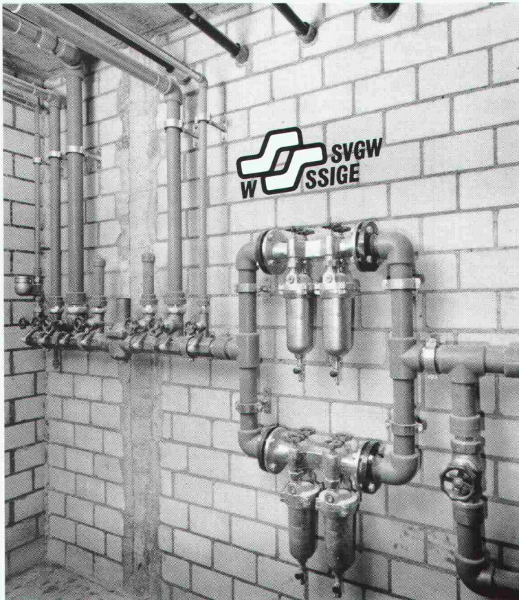
Verteilerbatterie in der Mövenpick-Raststätte «Heidiland» bei Sargans
