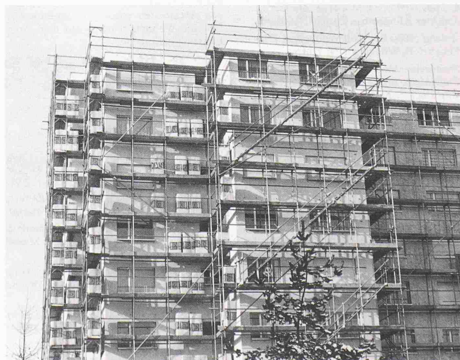
In den neunziger Jahren wird eine grosse Renovationswelle Hauseigentümer und Mieter betreffen (Bild: Comet)
