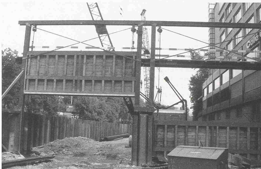
Bild 8. Fluttore unterhalb der Sihlbrücke. Linkes Tor während Bauarbeiten gezogen für die Durchfahrt des Baustellenverkehrs (Aufnahme SZU)
